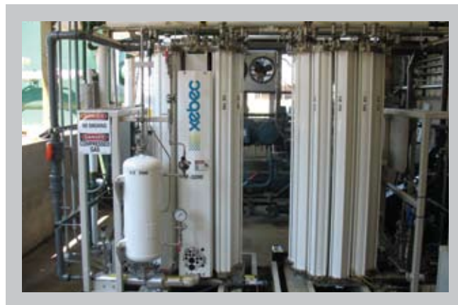
Le système de purification des gaz M-3200 de XEBEC, compact et fiable, convient parfaitement à la ferme laitière Scenic View.
