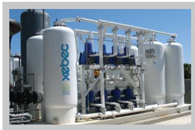
Le système de purification des gaz M-3100 de XEBEC installé au site d'enfouissement Rumpke permet d'alimenter les clients de Duke Energy, en Ohio, en gaz naturel transportable par pipeline.
